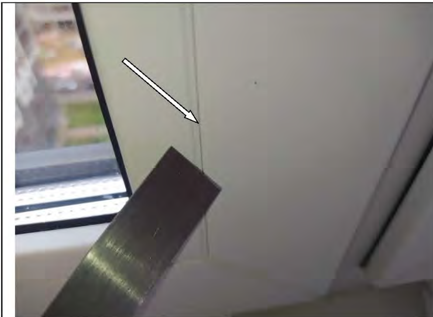
Фото №28. Профиль ПВХ оконного блока в кухне имеет дефекты (скол).
