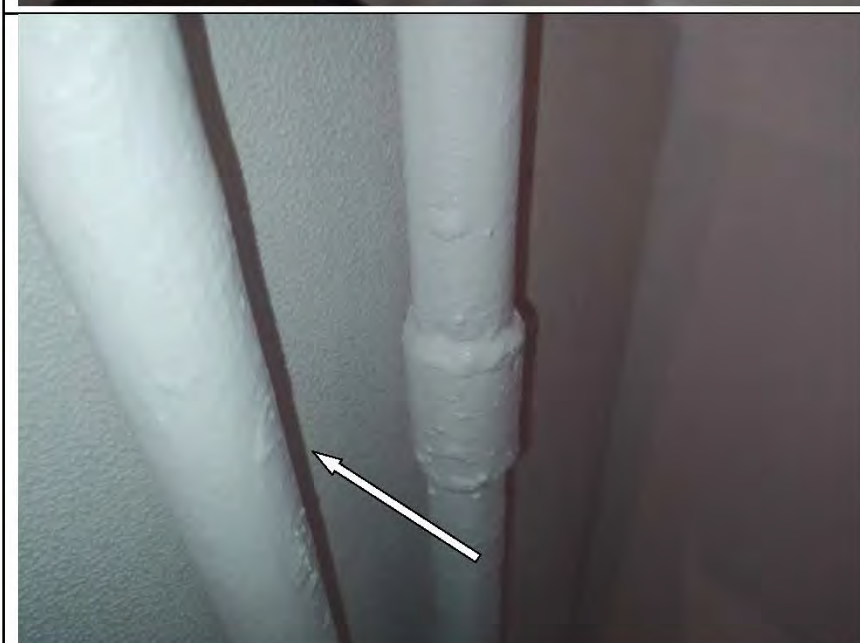
Фото №66. Окрашивание труб отопления выполнено с дефектами в гостиной (подтек).
