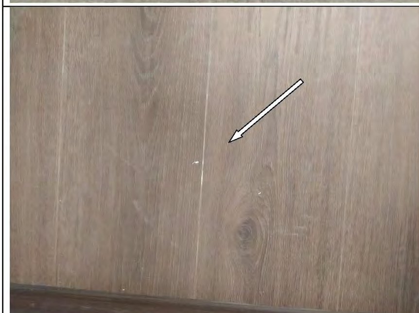
Фото №53. Загрязнения на поверхности ламината в спальне.
