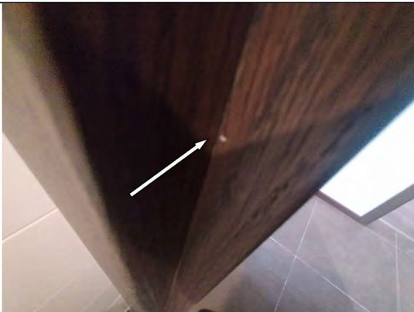
Фото №38. Коробка деревянного дверного блока в санузле имеет дефекты (скол).
