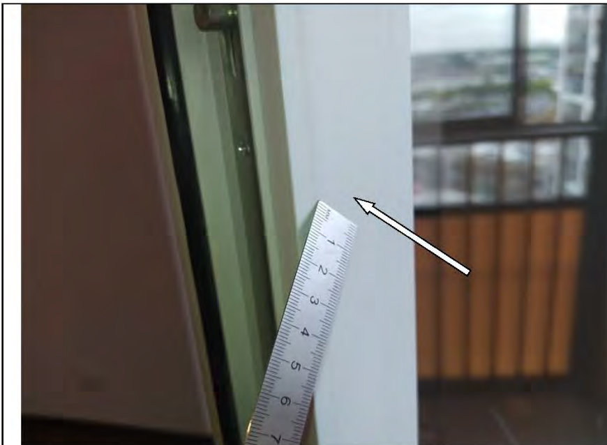
Фото №25. Профиль ПВХ оконно-дверного блока в гостиной имеет дефекты (царапина).
