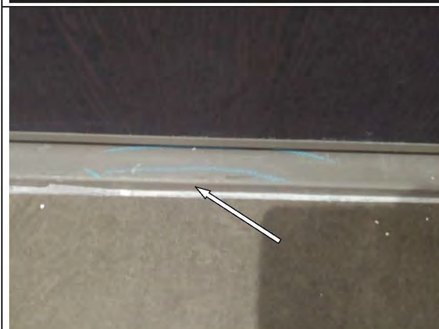
Фото №62. Коробка входной металлической двери имеет дефекты (замятие).
