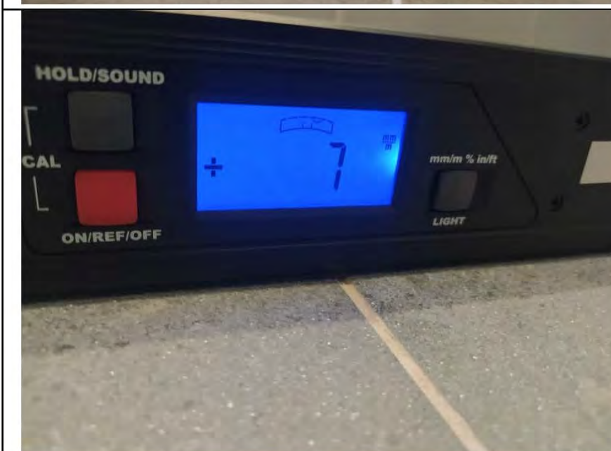
Фото №18. Измерение уровня напольного покрытия в ванной комнате (керамическая плитка).
