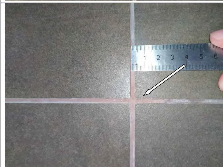
Фото №50. Затирка напольной плитки выполнена с нарушениями в кухне: разность ширины шва.
