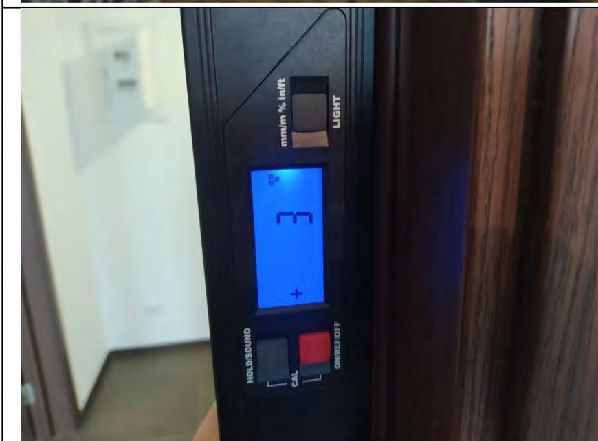
Фото №35. Отклонение коробки дверного блока в кухне.
