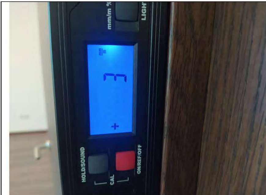
Фото №37. Отклонение коробки дверного блока в гостиной.
