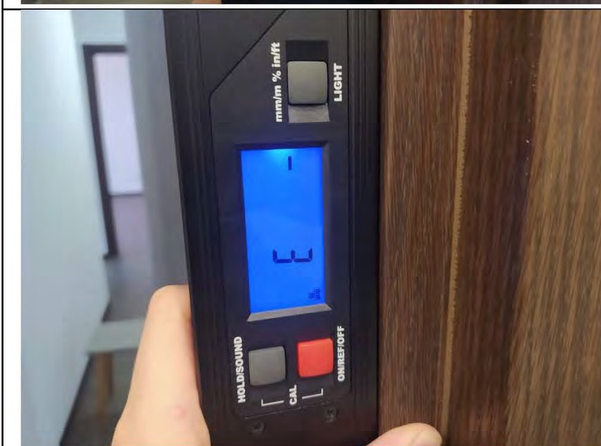
Фото №36. Отклонение коробки дверного блока в ванной комнате.
