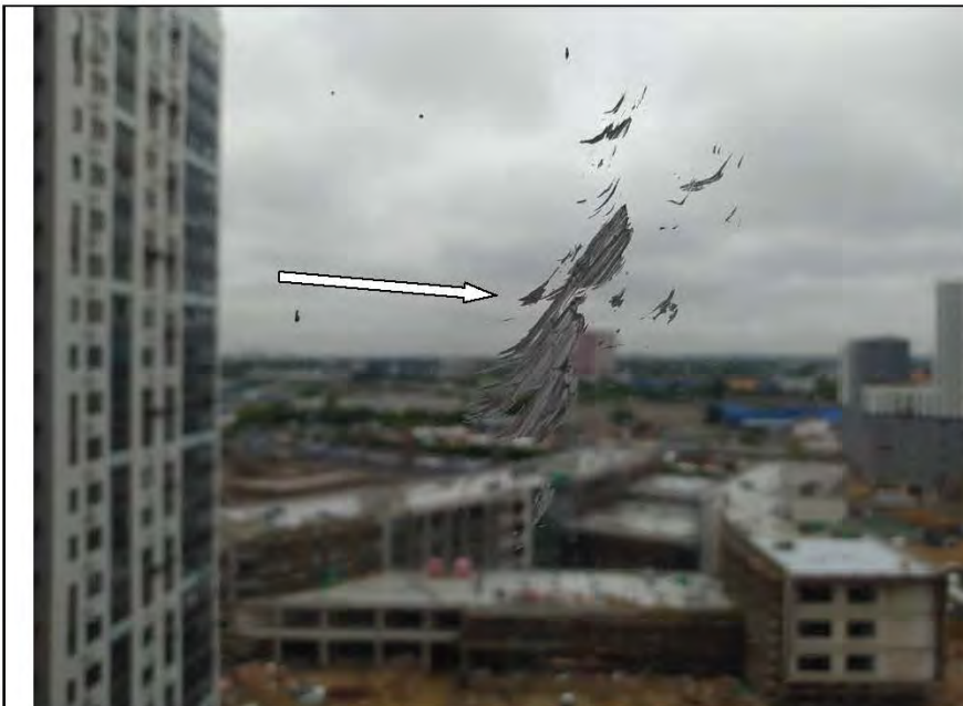
Фото №34. На стеклопакете оконного блока на лоджии имеется дефект (загрязнение малярными составами).
