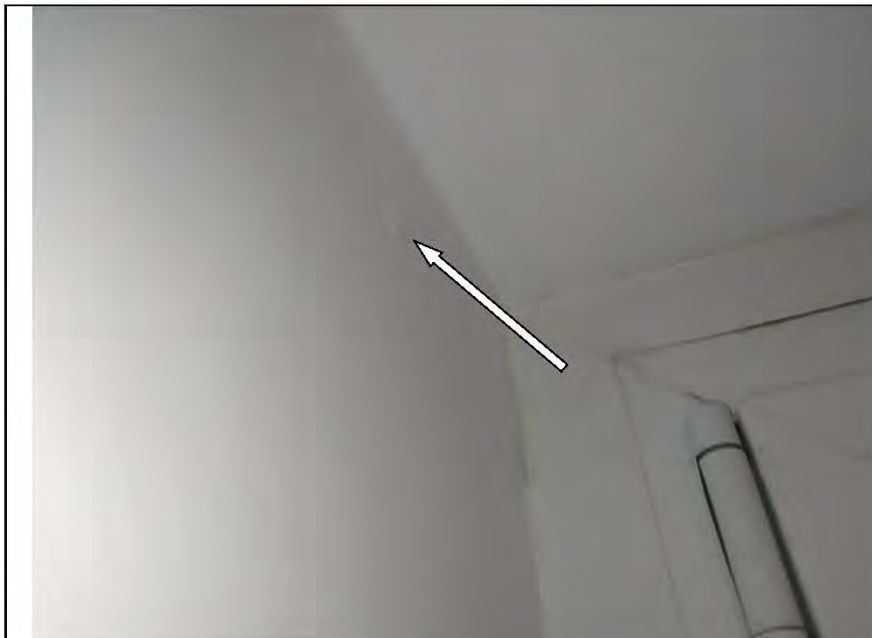
Фото №22. Окрашенные откосы оконного блока ПВХ в спальне выполнены с дефектами (брызги).
