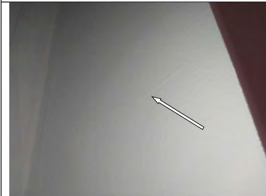
Фото №21. Окрашенные откосы оконно-дверного блока ПВХ в гостиной выполнены с дефектами (подтеки).
