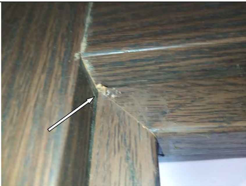
Фото №39. Коробка деревянного дверного блока в кухне имеет дефекты (скол).
