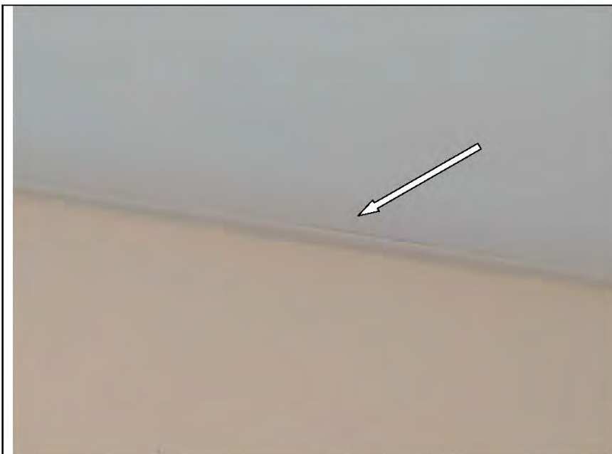
Фото №58. Дефект монтажа декоративного молдинга натяжного потолка в кухне.
