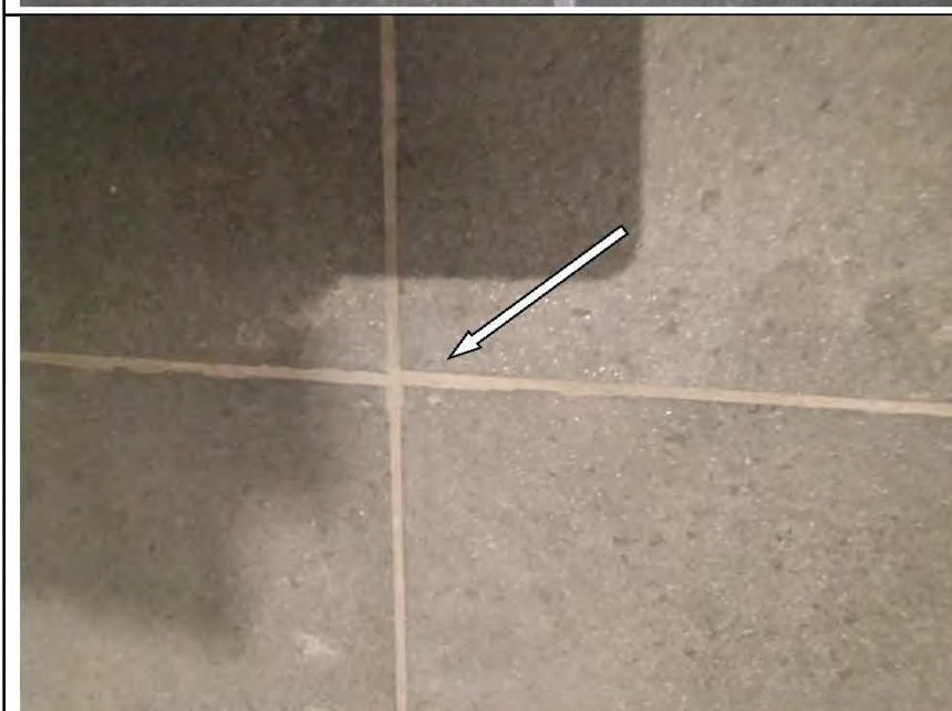
Фото №51. Затирка напольной плитки выполнена с нарушениями в санузле: разность ширины шва.
