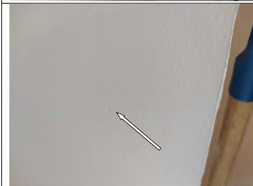
Фото №23. Окрашенные откосы оконного блока ПВХ в кухне выполнены с дефектами (брызги).
