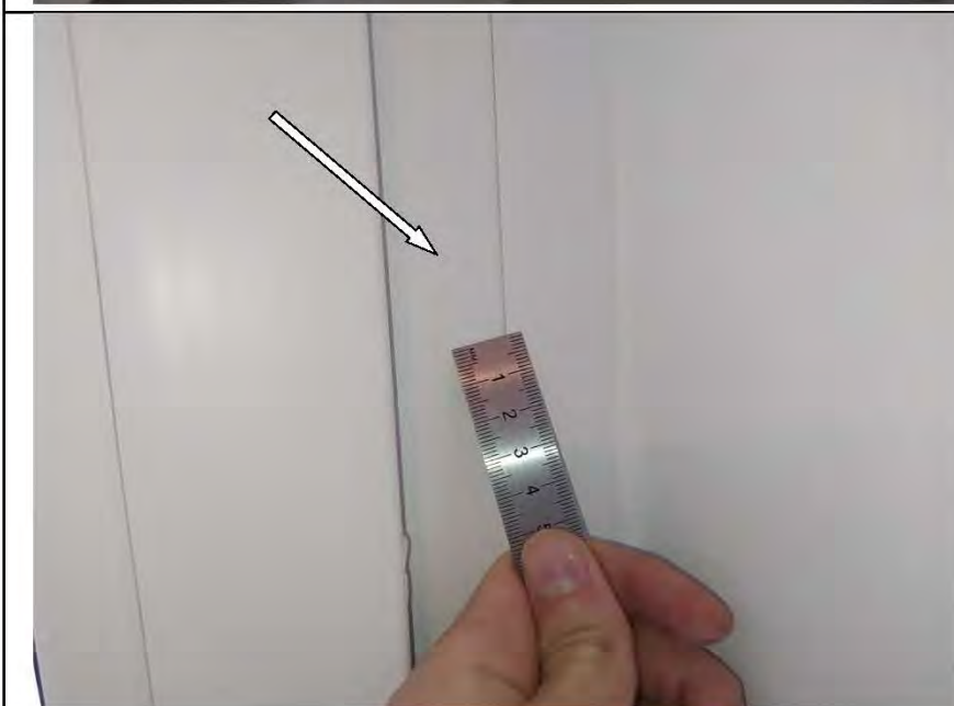
Фото №29. Профиль ПВХ оконного блока в кухне имеет дефекты (царапина).
