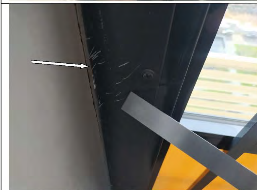
Фото №32. Дефект на металлическом профиле оконного блока на лоджии (царапины).
