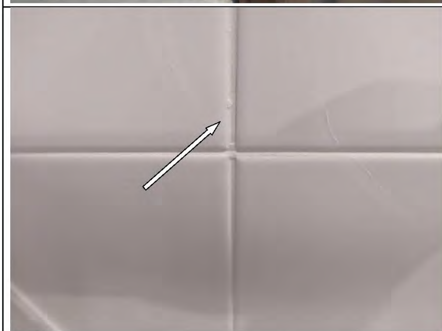
Фото №45. Затирка настенной плитки в ванной комнате выполнена с нарушениями (каверны).
