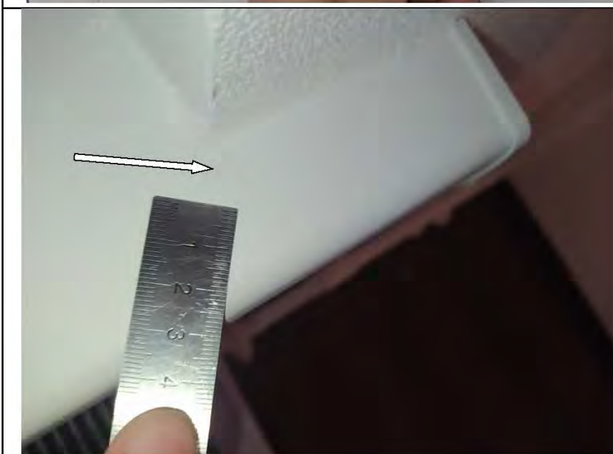
Фото №30. На лицевой поверхности подоконной доски в гостиной имеются дефекты (царапины).
