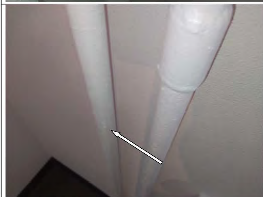
Фото №65. Окрашивание труб отопления выполнено с дефектами в спальне (подтек).
