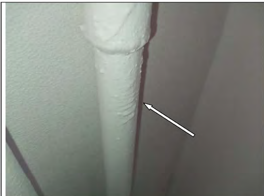
Фото №64. Окрашивание труб отопления выполнено с дефектами в кухне (подтек).
