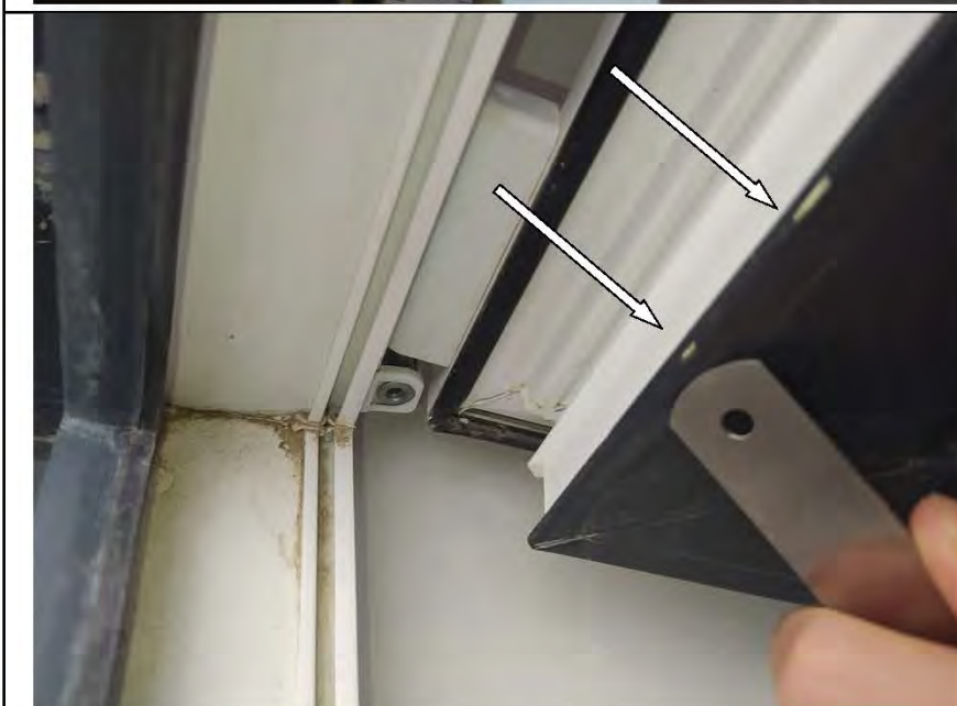
Фото №26. Профиль ПВХ оконного блока в спальне имеет дефекты (скол).
