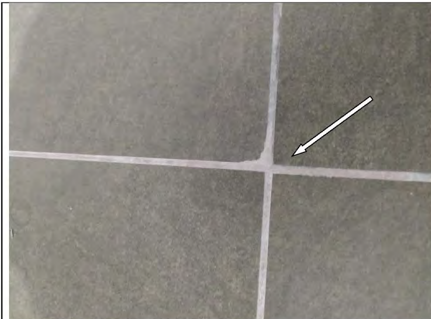
Фото №49. Затирка напольной плитки выполнена с нарушениями в прихожей: разность ширины шва.
